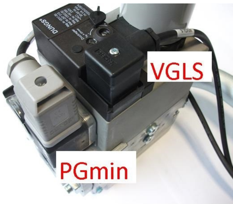
Fig. 7 Электрические соединения к газовой магистрали
