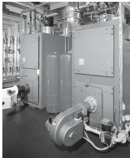
Контроль входного давления в котлах большой мощности
